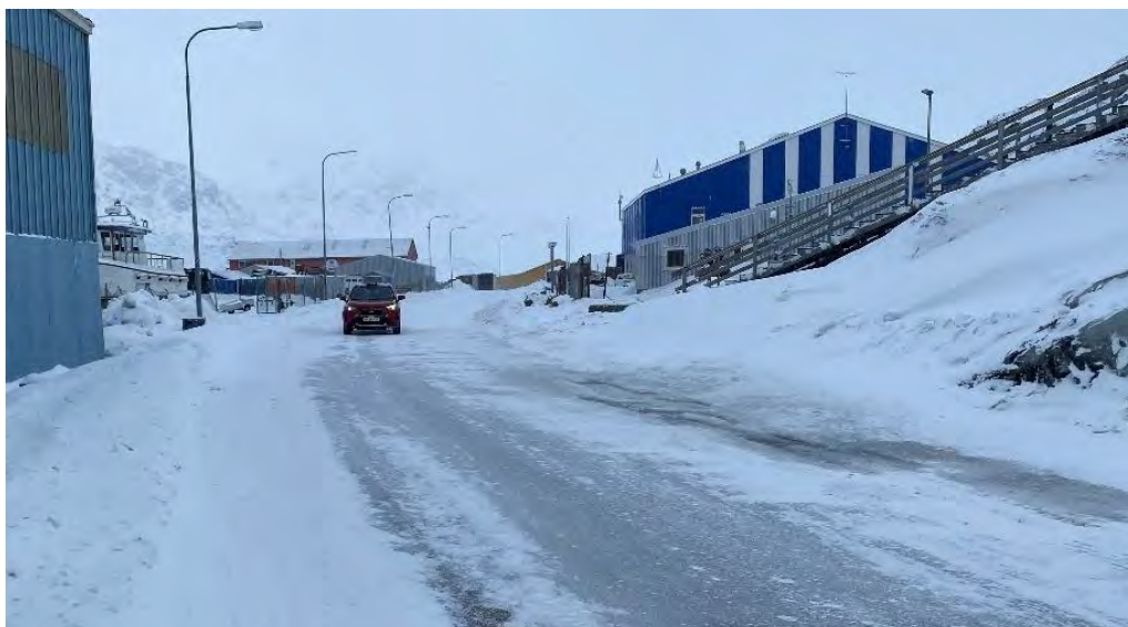
Foto 86: Muunup Aqq. vest for Asummiunut er der is på kørebanen som følge af afvanding fra fjeldet syd for vejen. Trappe over fjeldet ses til højre. Bedre afvanding til grøft kan være med til at mindske problemet.
